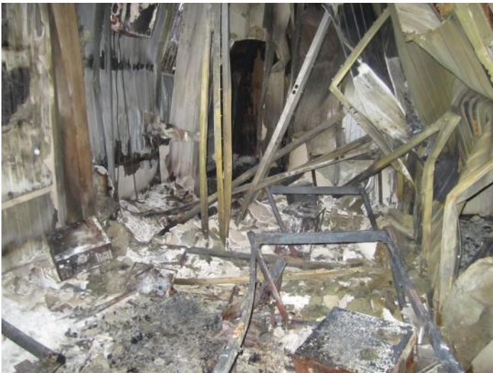
Palon jälkiä Venäjällä
